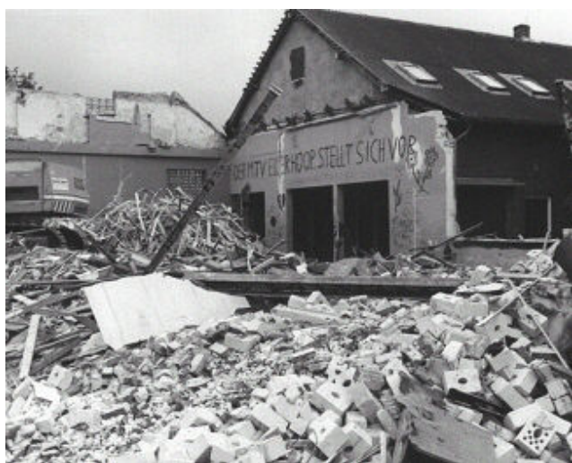
Im Oktober 1991 ist es soweit, die im Jahre 1891 erbaute alte MTV Turnhalle wurde abgerissen, damit die neue, größere Sporthalle gebaut werden konnte.
